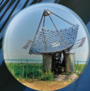
PRODUCTION D'ÉLECTRICITÉ PAR CPV
